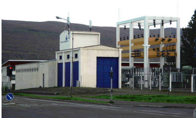
Mynd 25. Spennistöð Akureyrar. Arkitekt Sigvaldi Thordarson. Ljósmynd B.J. (Mynd verður skipt út).
